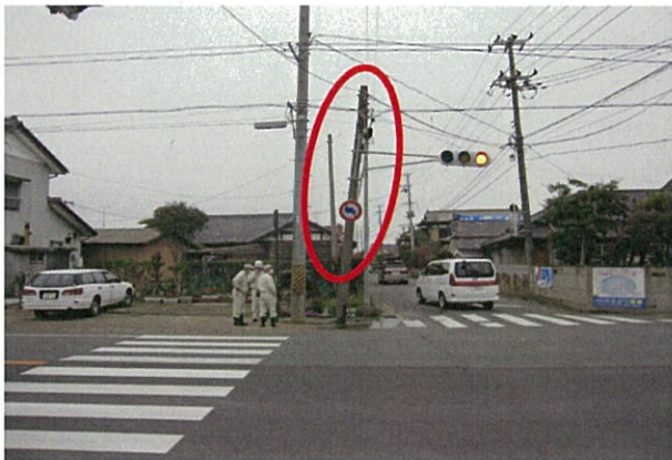
〈泉町下川付近〉 2期配水路からの漏水 により信号機が傾く
