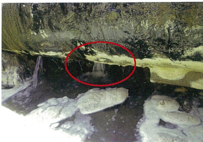
＜磐城工業用水道＞ 配水管（φ 1,100mm） （漏水状況）
