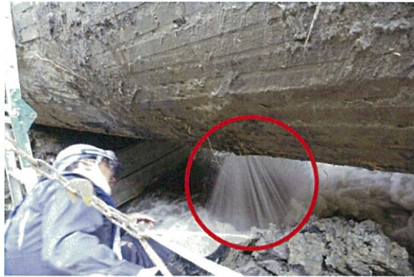
〈受水企業工場内 の漏水〉
