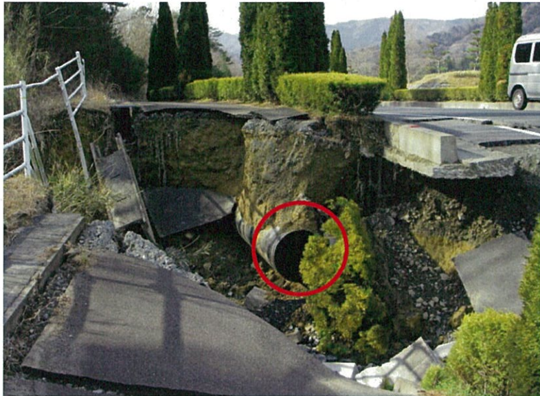
＜相馬工業用水道＞ 配水管（φ 600mm） （被災状況） （終点側から浄水場を望む）
