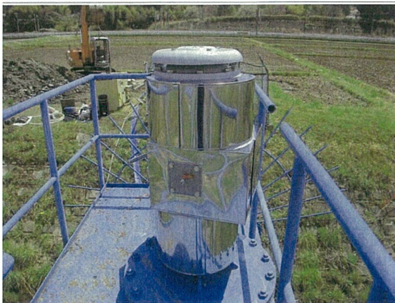
＜磐城工業用水道＞ 空気弁（渋川第一水管橋） （復旧完了）
