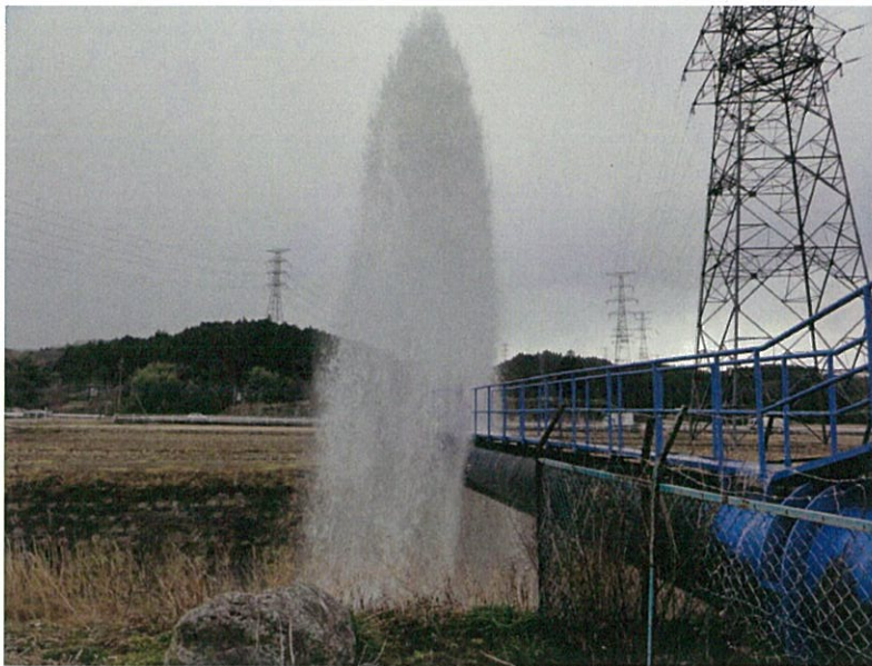
＜磐城工業用水道＞ 空気弁（渋川第一水管橋） （漏水状況）
