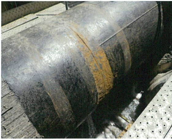
漏水箇所は接合部の溶接箇所
