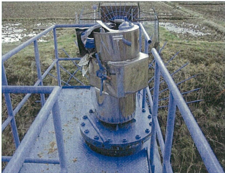
＜磐城工業用水道＞ 空気弁（渋川第一水管橋） （破損状況）
