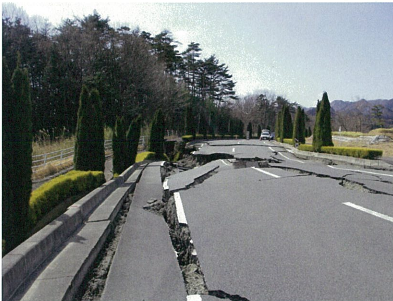
＜相馬工業用水道＞ 市道（被災状況） ＜終点側から浄水場を望む＞
