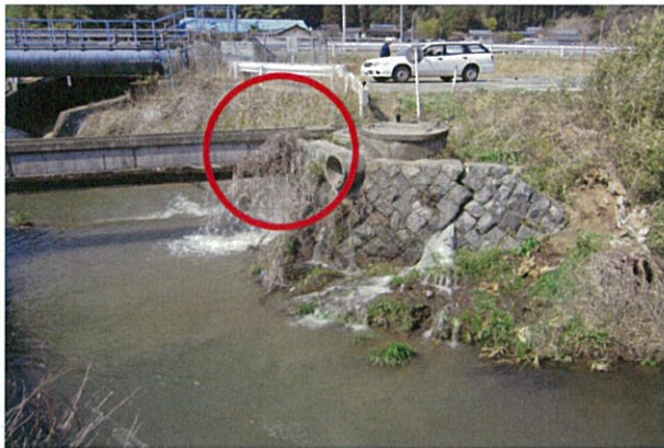
〈渋川第2水管橋付近〉 排水管接続部からの漏水 （4月13日）
