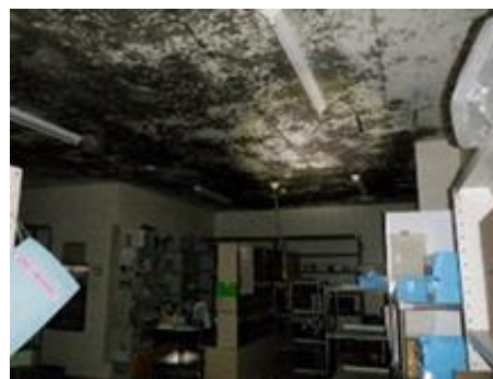
内壁・天井カビ発生
