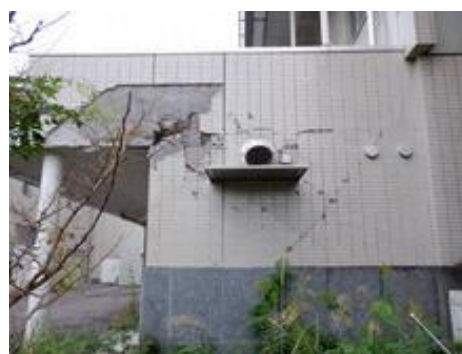
タイル浮き・クラック・剥離
