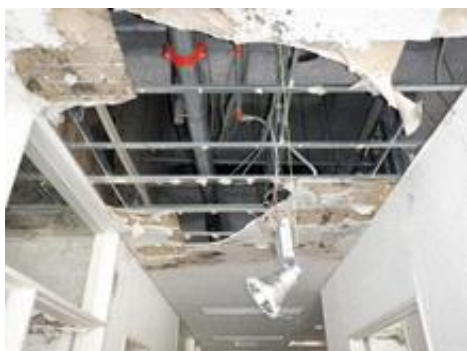
天井漏水跡、仕上材剥離
