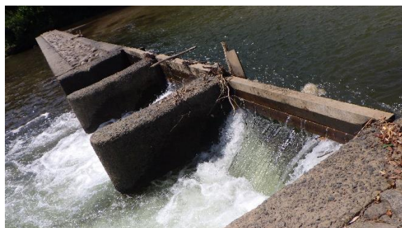
図33 堰堤中央部の切り欠きの様子
