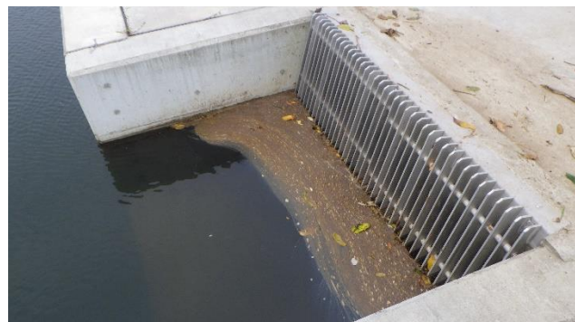
図7 魚道出口に隣接した取水口
