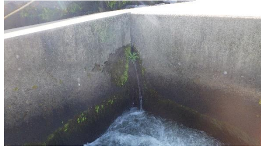
図42 魚道側壁の亀裂
