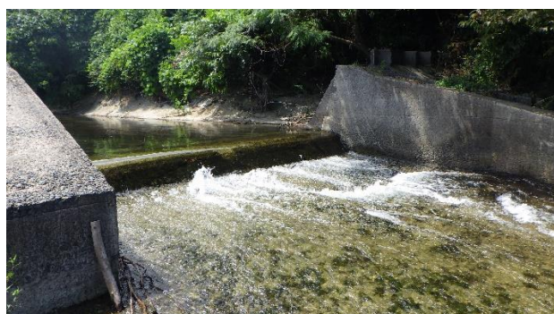
図11 堰堤左岸側のタタキの状態
