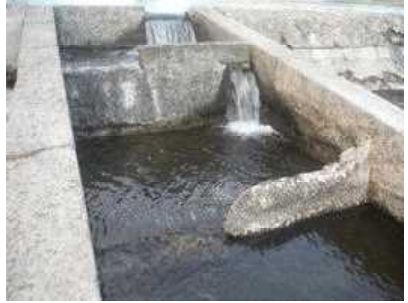
図 12 隔壁の破損状況
