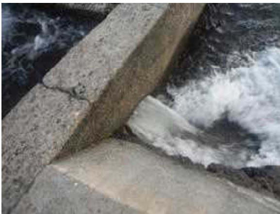
図 13 側壁の破損状況
