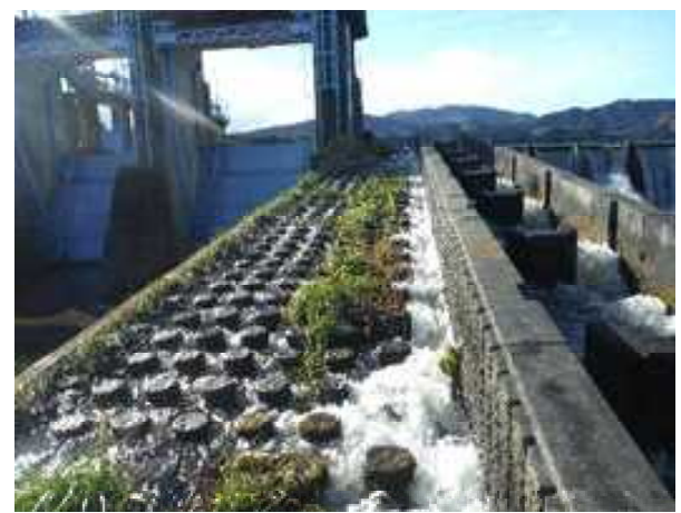
図 34 植物繁茂の状況
