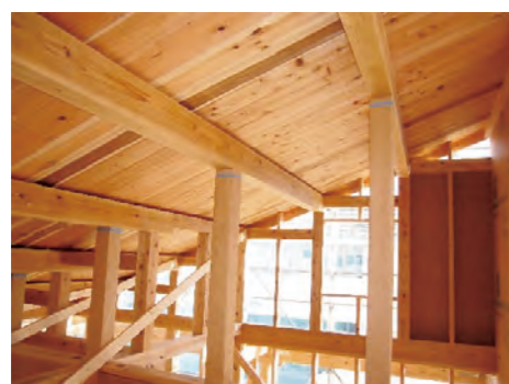
断熱材未施工の小屋裏
