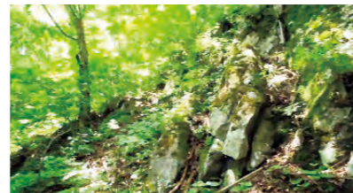
道路上部の不安定な地山の状況
