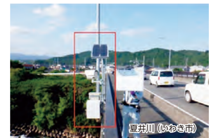
簡易型河川監視カメラ*14
