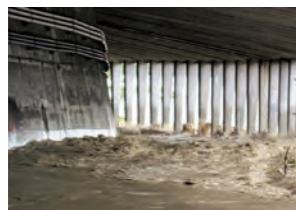
喜多方西会津線(峯) 被害状況
