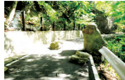
道路通行を妨げる落石
