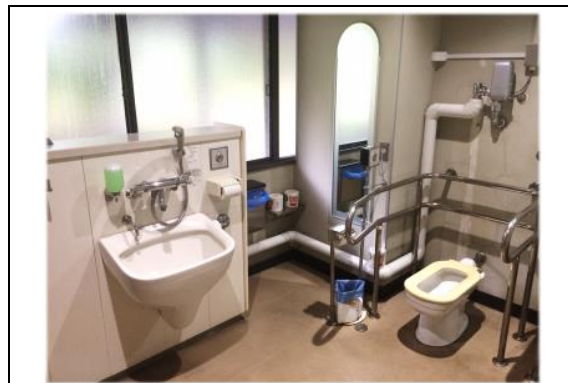
オストメイト対応トイレ（広島県）
