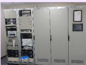
地震・堤体挙動の観測装置
