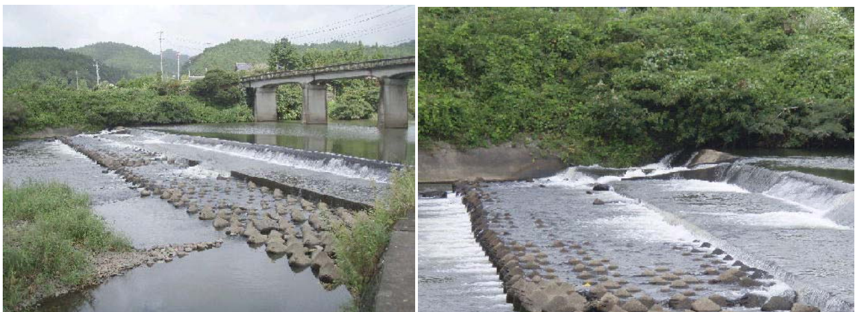
写真4 法田堰の魚道
