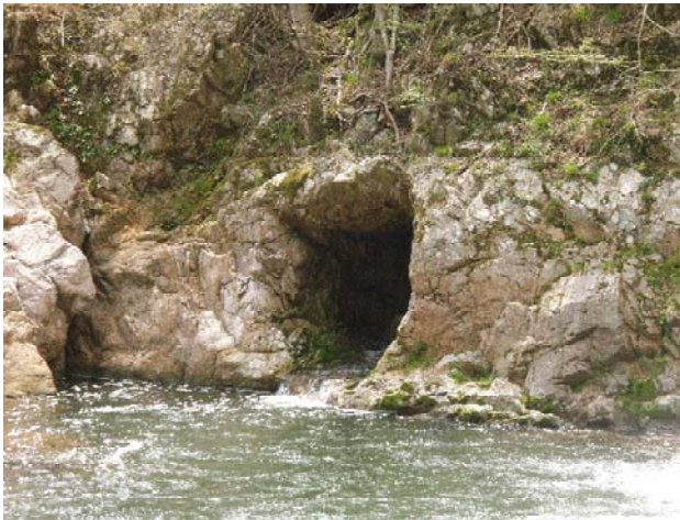
写真4 流木除去前の魚道入口
