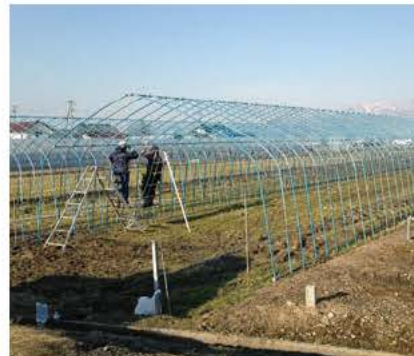
今年増やしたミニトマトのハウスの設営の様子。8棟約660坪をパートを雇い栽培している。
