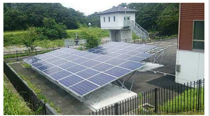
揚水機場に設置された太陽光パネル
