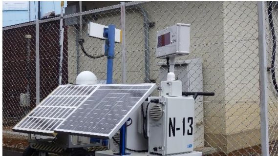
(写真5-1) MP-7に隣接して設置してある可搬型モニタリングポスト
