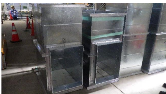
(写真 2 - 2) 1 階換気空調設備用のダクト
