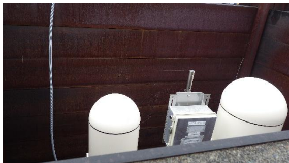
(写真7-2) MP-8の放射線検出器 (遮へい壁の内側)
