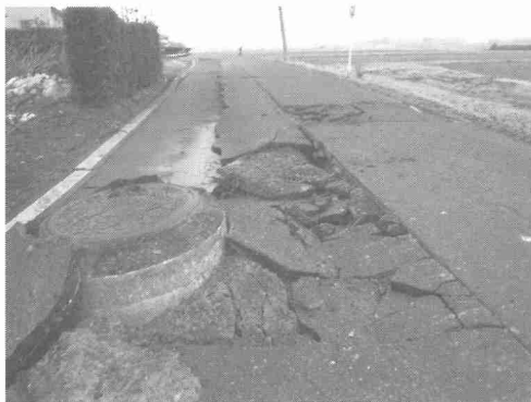
市道から飛び出たマンホール
