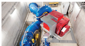
《水力発電所》維持管理
