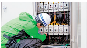
《太陽光発電所》保守要員による保守点検状況
