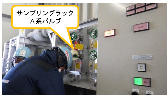
(写真1①) サンプリングラックのバルブ操作
