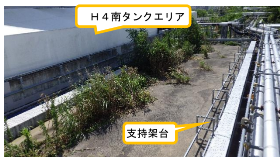
(写真 1 ①) H4南タンクエリア西側の状況
