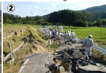
▲地震による農道の被害
