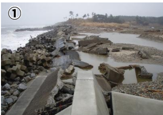
▲津波による堤防の被害
