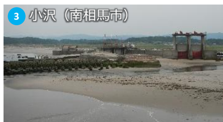
堤防の決壊・樋門の損壊
