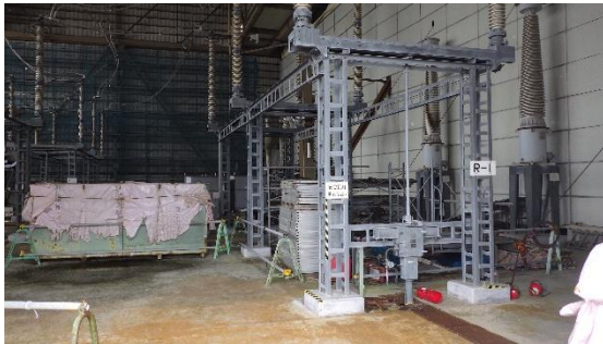
(写真 2－1) 1・2号機超高圧開閉 所の建屋内の状況
