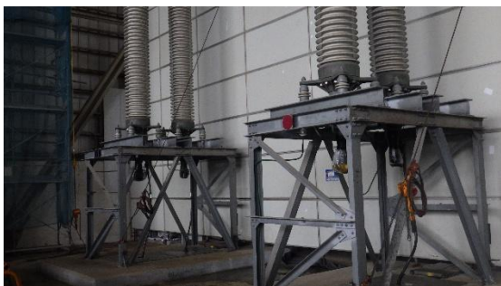
(写真 2－2) 油の漏えいが確認され たケーブルヘッドの状況
