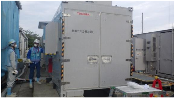
(写真 1－1) 窒素ガス分離装置（C系）の外観
