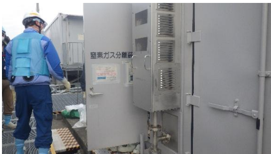
(写真 2) 窒素ガス分離装置（B系）の外観
