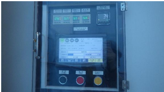
(写真 1－2) 窒素ガス分離装置（C系）の操作パネル
