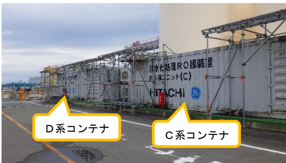
(写真2-2) 雨水淡水化处理RO膜装置 (RO膜ユニット (C系、D系))
