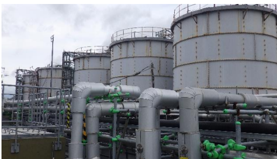
(写真2-3) 雨水受入タンク及び雨水処理水タンク
