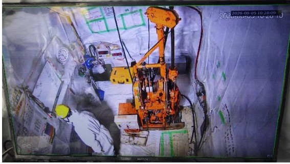
(写真4-2) 遠隔監視用画面の様子
