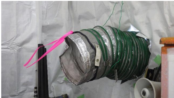
(写真 2) 作業ハウス内の冷風設備
