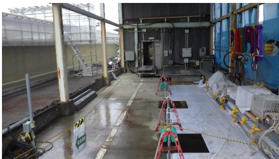
(写真5) 旧窒素ガス分離装置（C系）が設置されていた場所の状況
