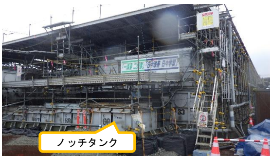
(写真2) ノッチタンクの保管状況
