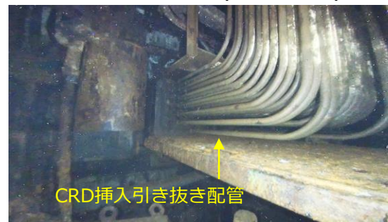
②：CRD挿入引き抜き配管(北東)
