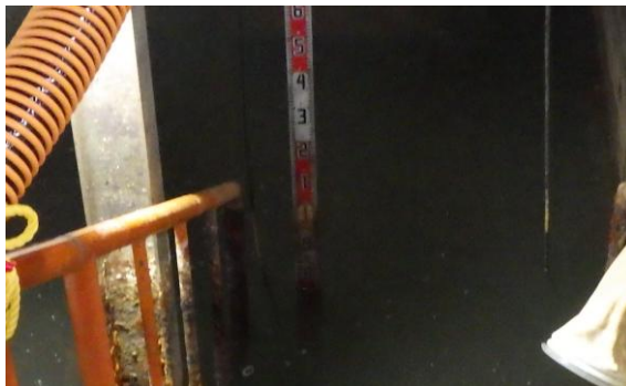
(写真 1 - 4) 6号機タービン建屋地下階の水位
