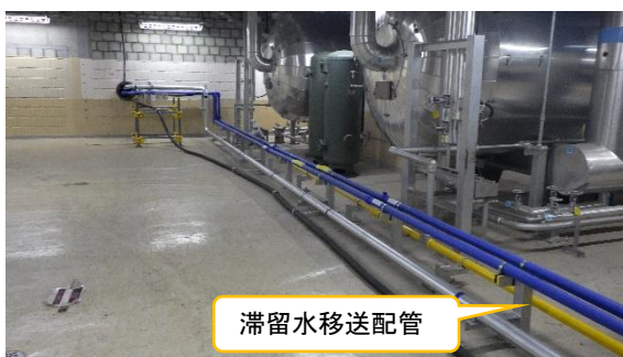
(写真 2 - 2) 滞留水移送用の配管の状況②
