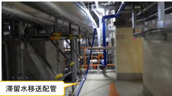
(写真 2 - 1) 滞留水移送用の配管の状況①
