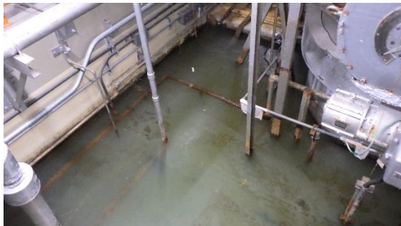
(写真1-1) 5号機タービン建屋地下階における 滞留水の状況
