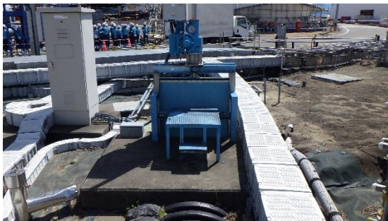
(写真2-2) 電動開閉ゲート (C-1) の状況
