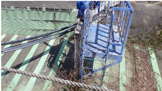
(写真2-1) 電動開閉ゲート (BC-b) の状況
