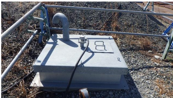
(写真3②) 地下貯水槽No. 6の観測孔
