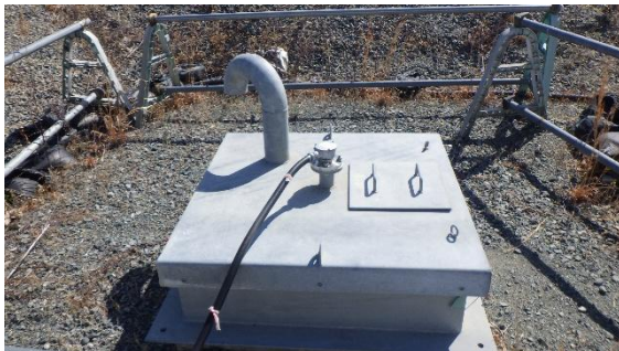
(写真4②) 地下貯水槽No. 7の観測孔
