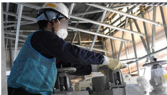
(写真3) 屋外受入バルブユニットにおける弁の操作状況
