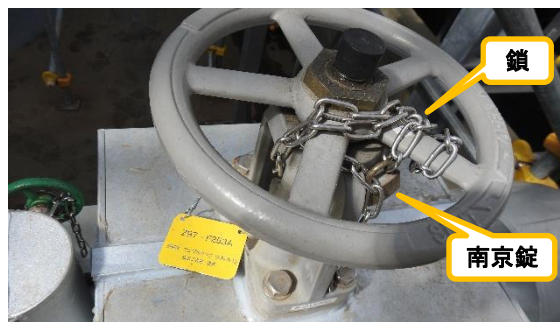
(写真2) 鎖及び南京錠による弁の施錠状況
