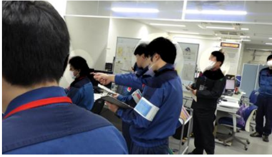
(写真5)免震重要棟集中監視室におけるALPS処理水海洋放出開始時の監視・制御装置の操作状況
