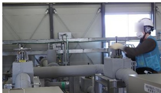
(写真4) 多核種移送設備建屋における弁の操作状況
