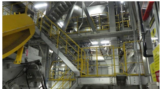
溶融炉（灰処理施設） 異常なし
