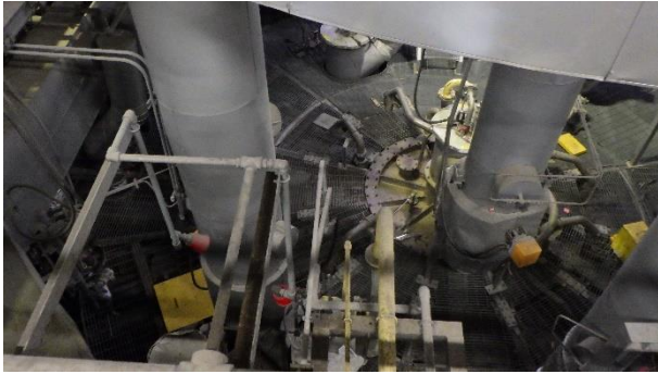
不活性ガス消火設備（灰処理施設） 異常なし
