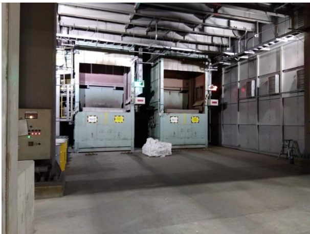
ごみ供給コンベヤ（焼却施設） 異常なし
