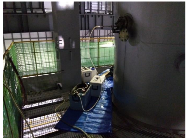
煙突（排ガスのモニタリング）（焼却施設） 異常なし
