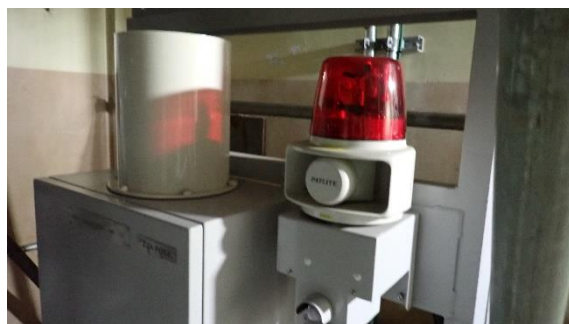
(写真 3－1) エリアモニタの状況
