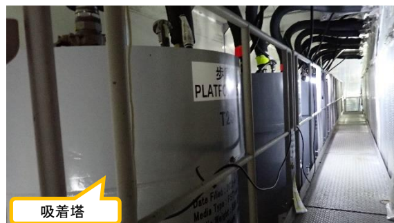
(写真 1－2) 吸着塔の外観 （手前 4 つが吸着塔で、奥 2 つがろ 過フィルタ）
