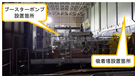
(写真 1－1) SARRY II の外観（北側から撮 影）
