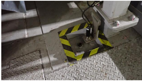
(写真 3 - 2) 漏えい検知器の状況
