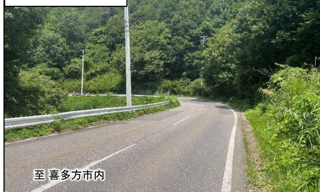
線形不良箇所
