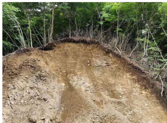
法肩の崩壊状況
