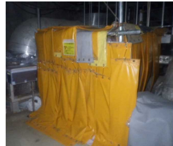
<高線量ドラム缶仮置き場所遮蔽設置後の状況>
