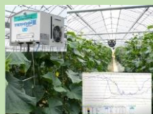
園芸施設の環境測定装置
