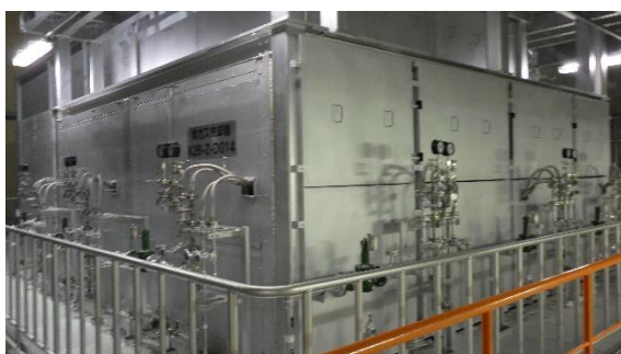
(写真2-2) 排ガス冷却器の外観
