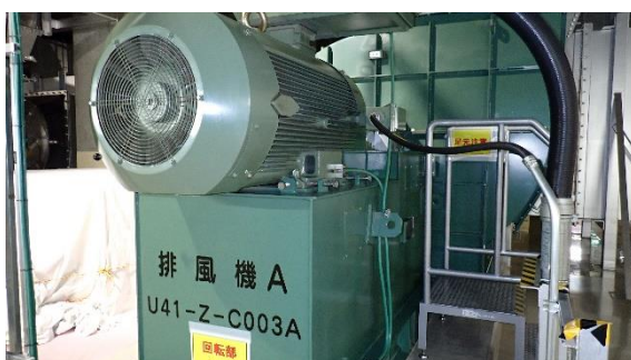
(写真3) 換気空調設備における排風機Aのポン プ ※排風機は3台設置されており、2 台が稼働していた。
