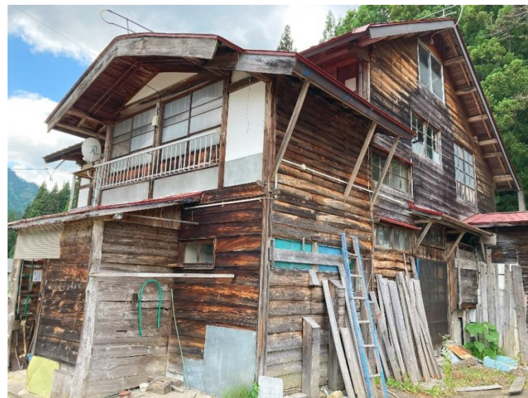
老朽化した空き家
