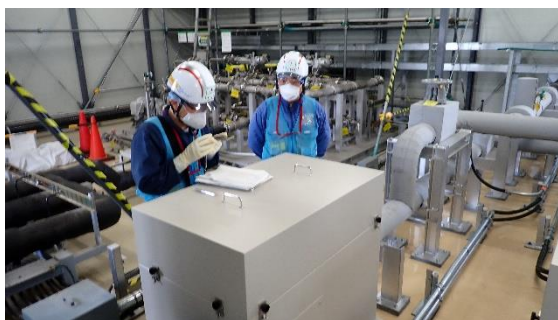
(写真2①)中央操作室のクロスチェック
