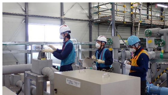
(写真1④) 移送設備建屋での弁操作
