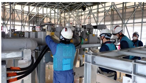
(写真1③) 屋外受入バルブユニットでの弁操作
