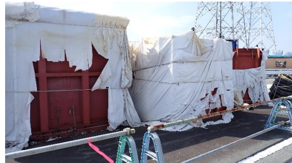
(写真3) シートの劣化状況
