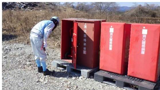
(写真 3 ①) 消火器の設置状況
