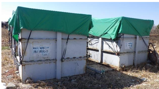
(写真 3 ①) 消火用タンクの設置状況
