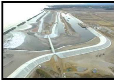
小高川・村上地区海岸(南相馬市)
