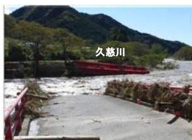
町道橋の落橋／高原橋（矢祭町）
