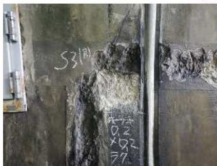
&lt;劣化状況&gt;
