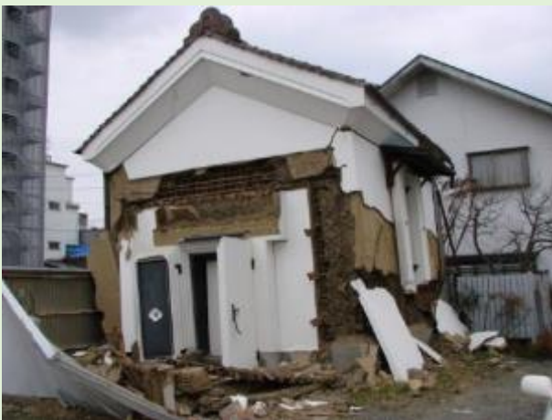
震災による被害の状況
