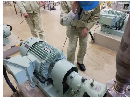
起動中のポンプの振音確認の様子 聴診棒での確認
