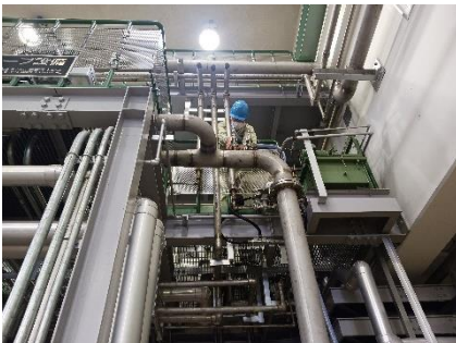
ループ設備操作の様子
