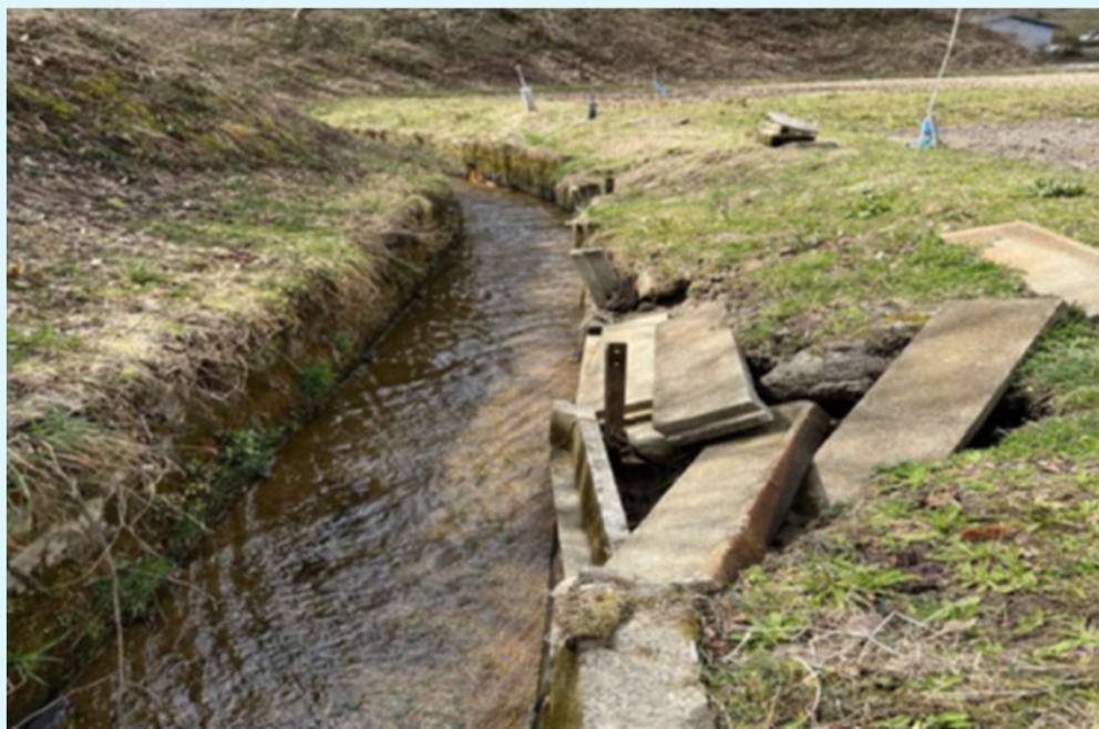
(参考) 農業用排水路損傷状況
