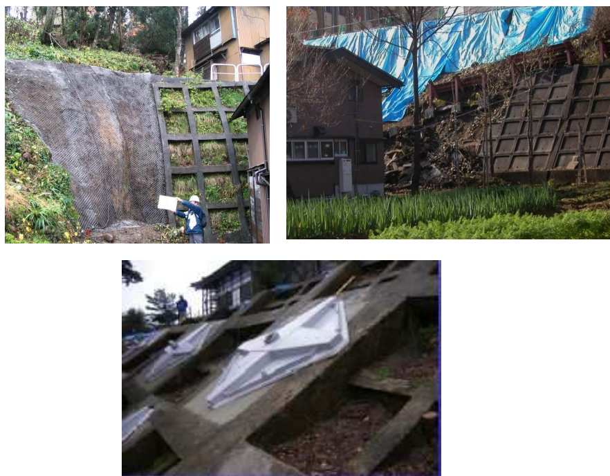
写 3-12 のり面保護工の変状の例
