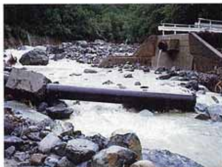
▲橋梁部埋塞状況(下流部)
