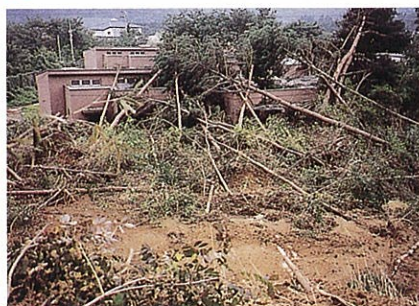
① けやき荘被災状況(一部損壊)
