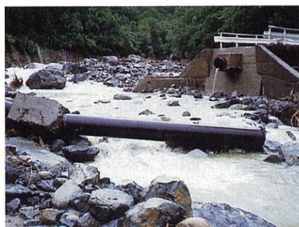
▲橋梁部埋塞状況(下流部)
