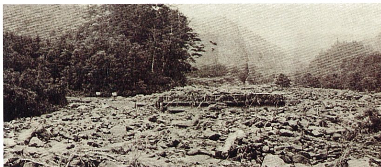
▲舟岐川上流河原荒廃状況(林道橋の埋没)
