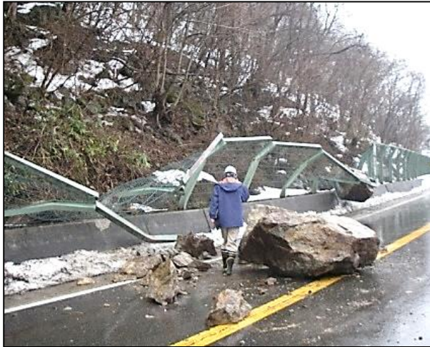
写真① 落石による通行止め状況 (H21.1.23)
