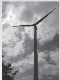
川内風力発電所 （川内電力㈱提供）
