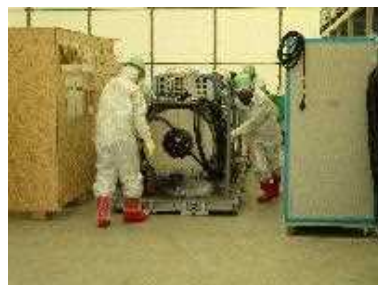
堆積物除去装置 (高圧水、AWJ) 設置
