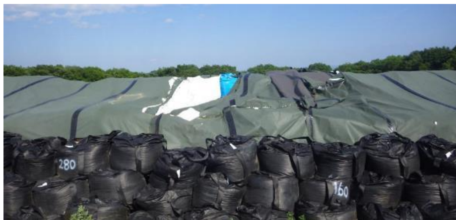
図8 通気性防水シートの破損例
