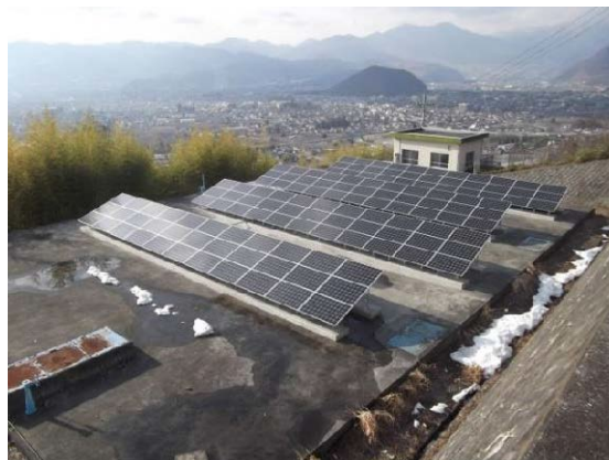
写真-41.2 調整池上面への太陽光発電施設の設置事例
